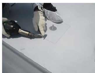
シート防水工事と同じ固定ビスと防水シートを使用。防水工事の技術で施工可能です。
