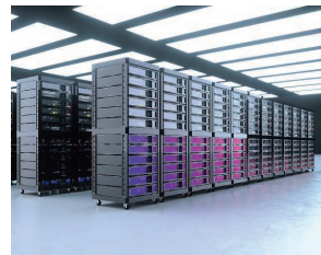
サーバールーム
