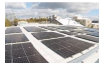
高耐久防水シート上 に施工された ソーラーシステム
